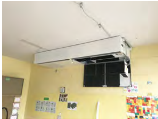
Abb. 4.19: Aufhängung des Deckenlüftungsgeräts an der (Außen-)Rückwand des Klassenraums gegenüber der Tafel.
