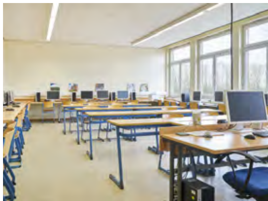
Abb. 4.2: Informatikraum einer Gesamtschule mit vorhandener abgehängter Decke und Anbauleuchten (vor Sanierung).
