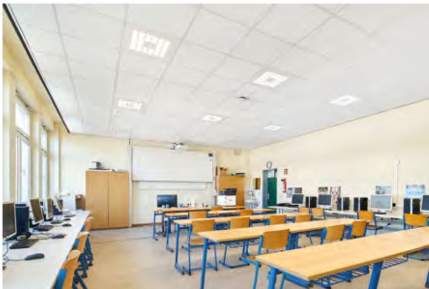
Abb. 2.13: Flächige, akustisch wirksame Systemdecke mit Einlegeleuchten.
