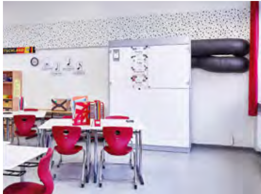
Abb. 3.15: Standlüftungsgerät (Kampmann GmbH & Co. KG) kombiniert mit akustischem Wandabsorber mit sichtbarer Rohrführung durch angrenzende Wand (Fall S, Sünte-Marienschule, Wietmarschen) [49].
