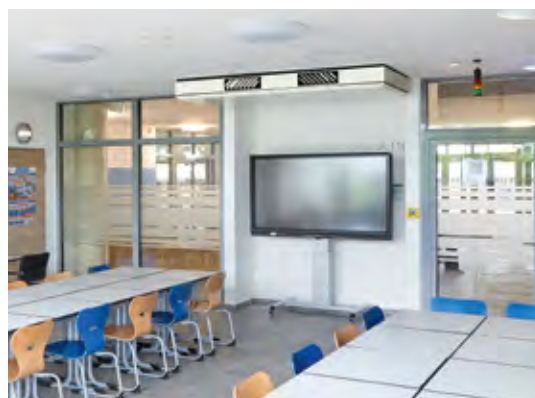
Abb. 3.9: 2/3-Teilintegration eines Deckenlüftungsgeräts (© Airflow Lufttechnik GmbH) in ganzflächiger Akustikdecke (Schulzentrum Much) [1].
