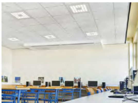
Abb. 3.12: Teilintegration eines Deckenlüftungsgeräts (TROX GmbH) in die Systemdecke mit Aussparung entlang der Fensterwand zum Öffnen der Oberlichter mit unsichtbarer Rohrführung durch die angrenzende Außenwand (Fall W-U0T, Seite 88).
