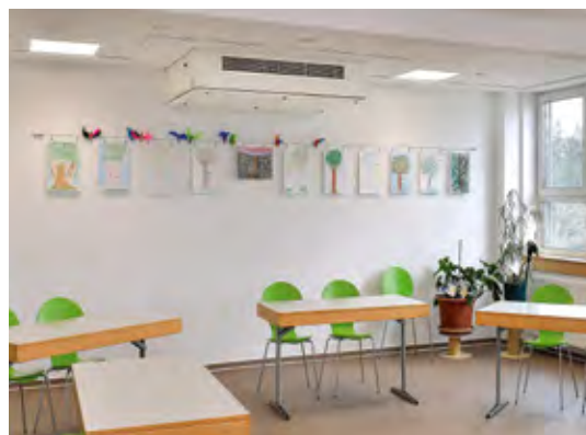
Abb. 3.11: Teilintegriertes Deckenlüftungsgerät (tecalor GmbH) in Systemdecke an Raumrückseite mit unsichtbarer Rohrführung durch angrenzende Wand (TSA Bildung und Soziales gGmbH, Jena).
