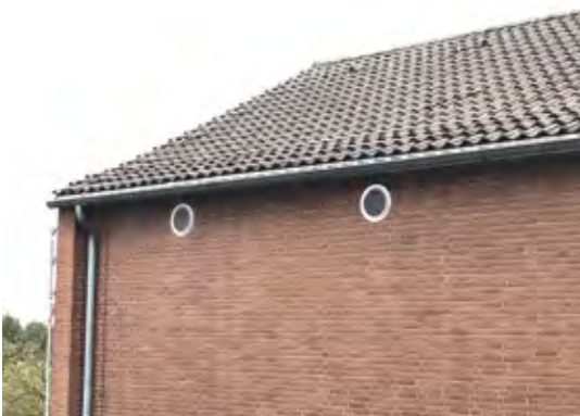
Abb. 4.22: Unauffällige Wetterschutzgitter an der Außenfassade für Fort- und Außenluft.
