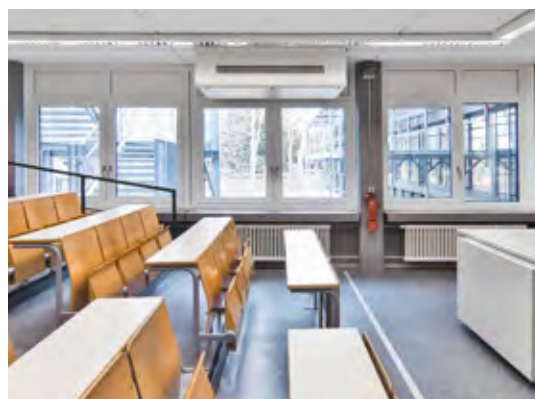
Abb. 3.13: Aufgesetztes Deckenlüftungsgerät (tecalor GmbH) direkt an der Fensterwand mit Rohrführung durch Oberlicht-Bereich (Einhard-Gymnasium, Aachen) [89].
