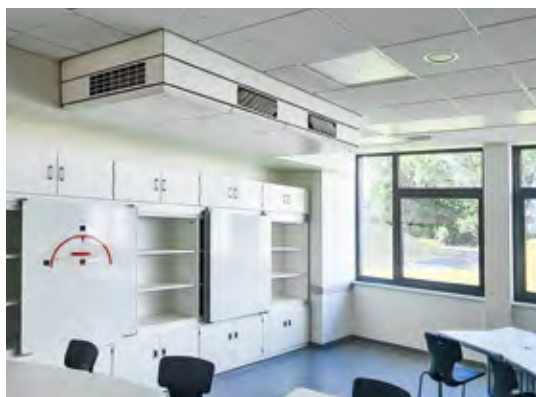
Abb. 3.10: 1/3-Teilintegration eines Deckenlüftungsgeräts (© Airflow Lufttechnik GmbH) in Systemdecke mit abgekofferter Rohrführung durch Fensterwand (Rachel-Carson-Schule, Dormagen) [2].
