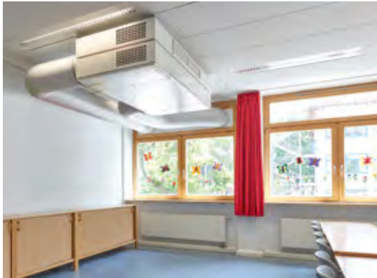
Abb. 3.14: Aufgesetztes Deckenlüftungsgerät (Swegon Germany GmbH) an Raumrückseite mit sichtbarer Rohrführung durch Isopaneel an ehemaliger Oberlichtposition (Grundschule Olching) [86].
