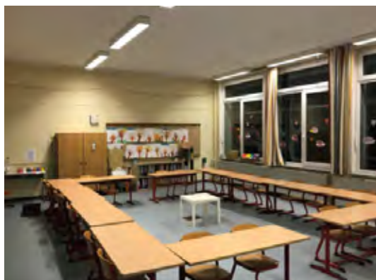
Abb. 4.3: Schallharte Betondecke und fragwürdige Positionierung der fensternahen Leuchtstoffröhren in einer Grundschule (vor Sanierung).
