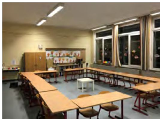
Abb. 4.17: Schallharte Betondecke und fragwürdige Positionierung der fensternahen Leuchtstoffröhren in einer Grundschule (vor Sanierung).
